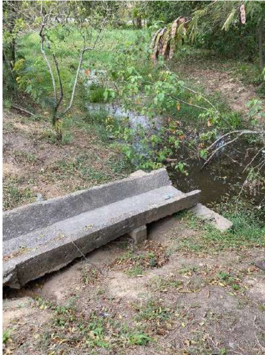
FIGURA 61 – CANALETA POR ONDE ESCOA A ÁGUAS PLUVIAIS COLETA DA RODOVIA PRESIDENTE DUTRA. FONTE: ACERVO DO AUTOR, 2023
